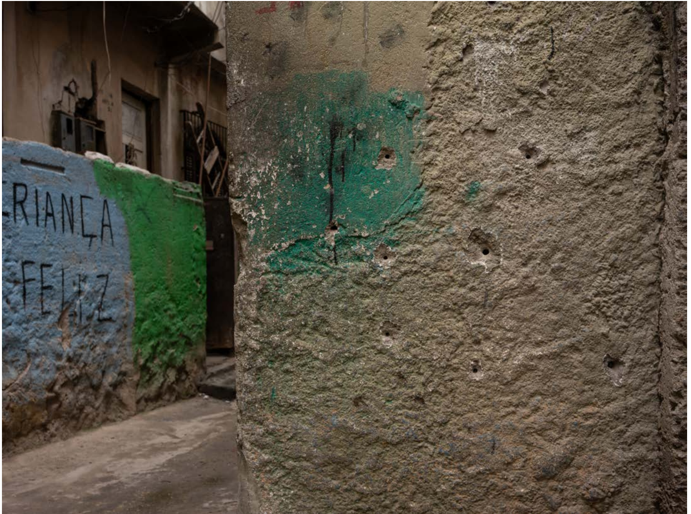
Marcas de tiro em muro da comunidade do Jacarezinho, no Rio
